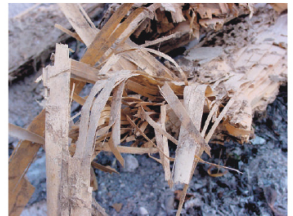
Dégâts causés par les termites.
